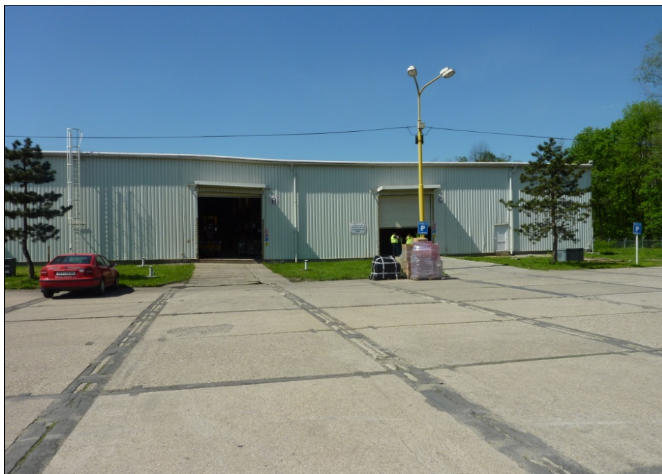
Obrázek 47 Poškození vstupní brány B skladovací haly Canis Safety a.s.
